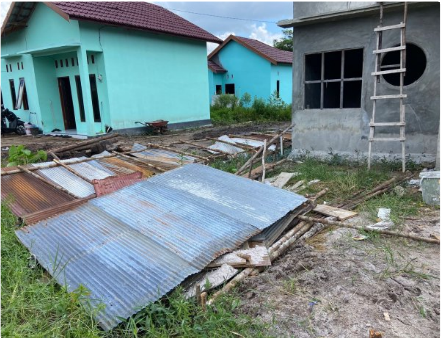
Gambar: Kondisi Pagar Seng Yang Dirusak Oknum
